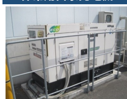
非常用自家発電機
